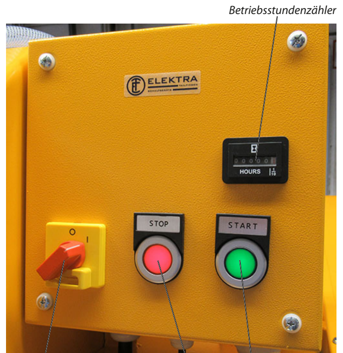
Netztrennschalter NOT-AUS STOP START Schalterkombination CTS-265.2
